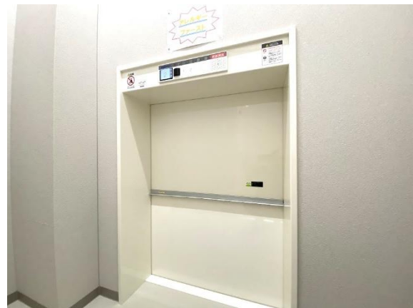
給食専用エレベーター
